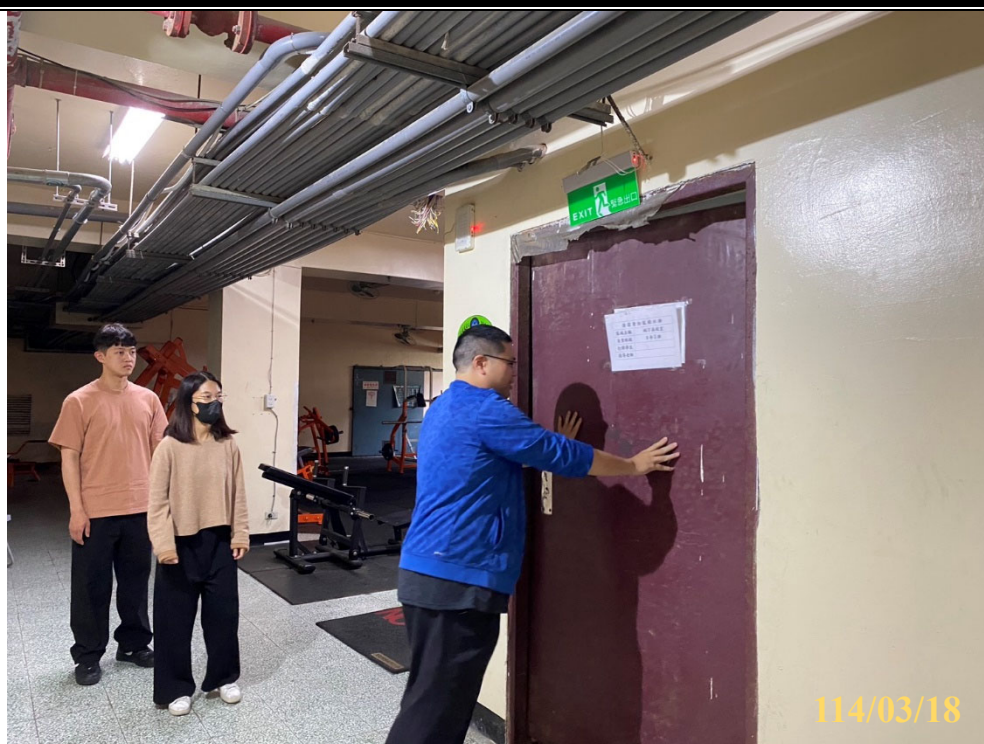
說明：避難逃生情形-防火門區劃。
